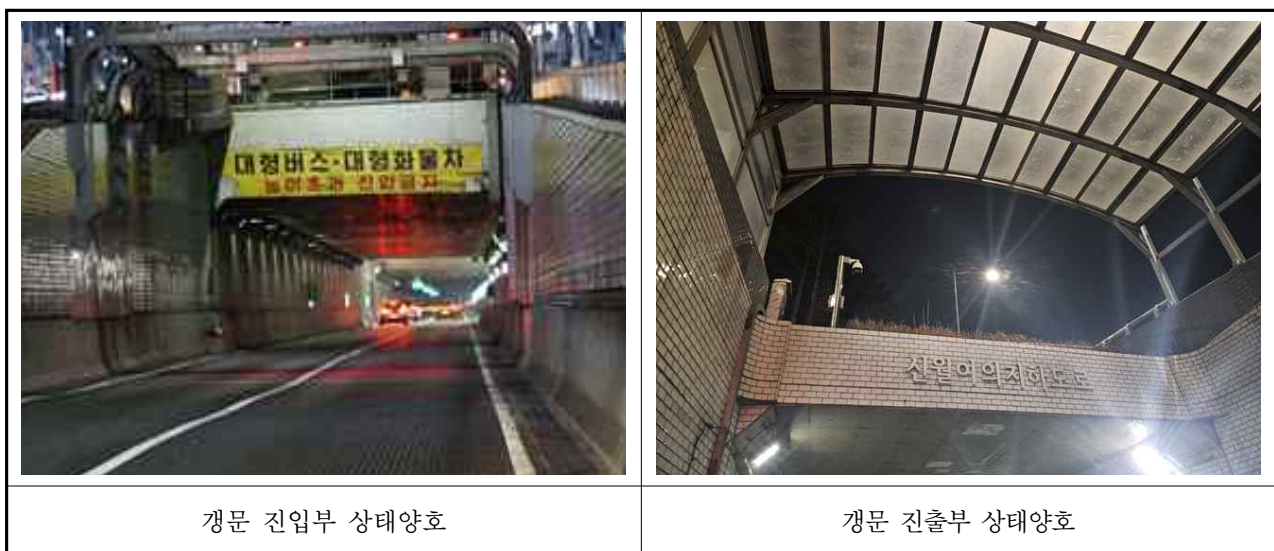
【사진 3.3.18】갯문 손상현황
