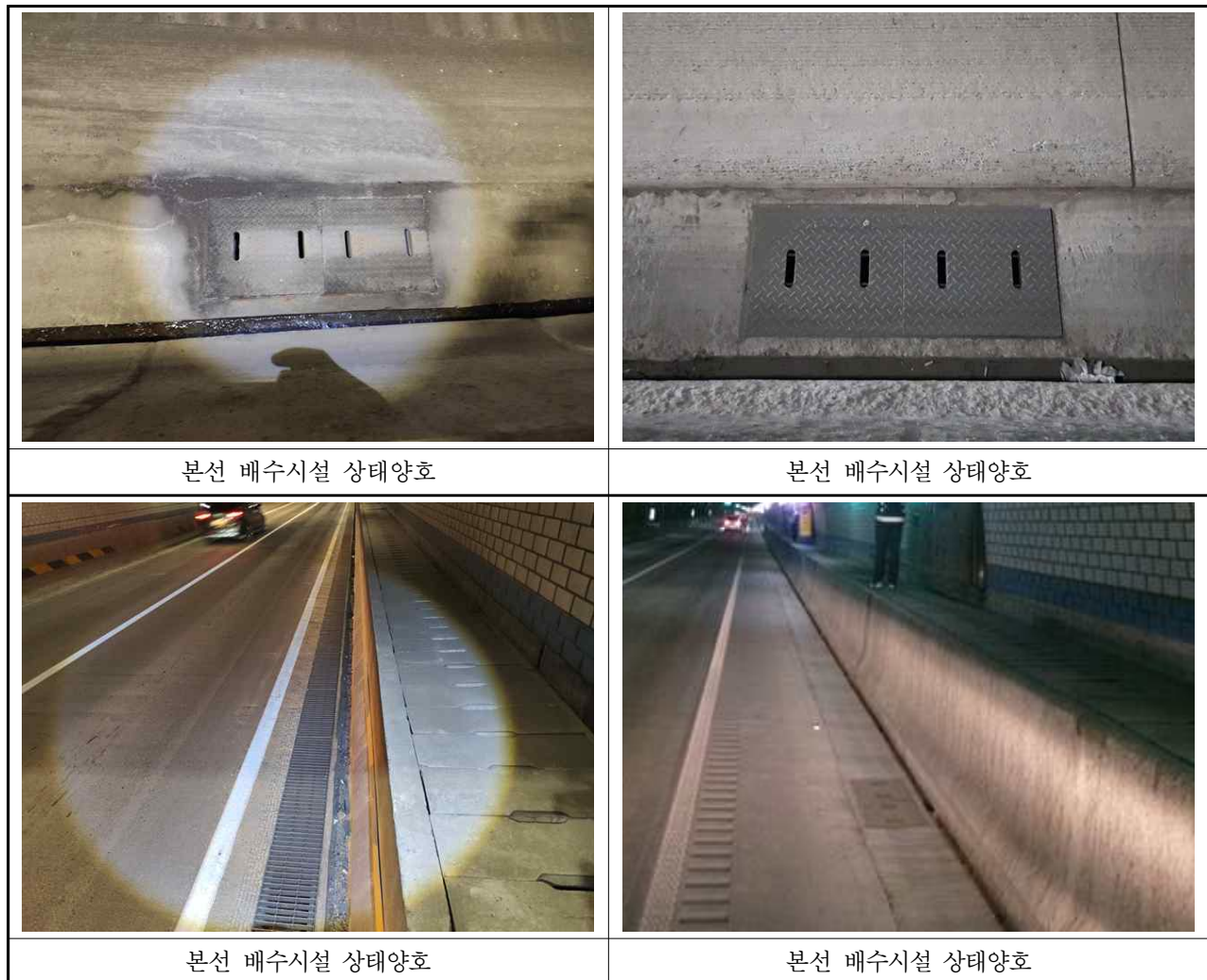
【사진 3.3.16】 배수시설 손상현황
