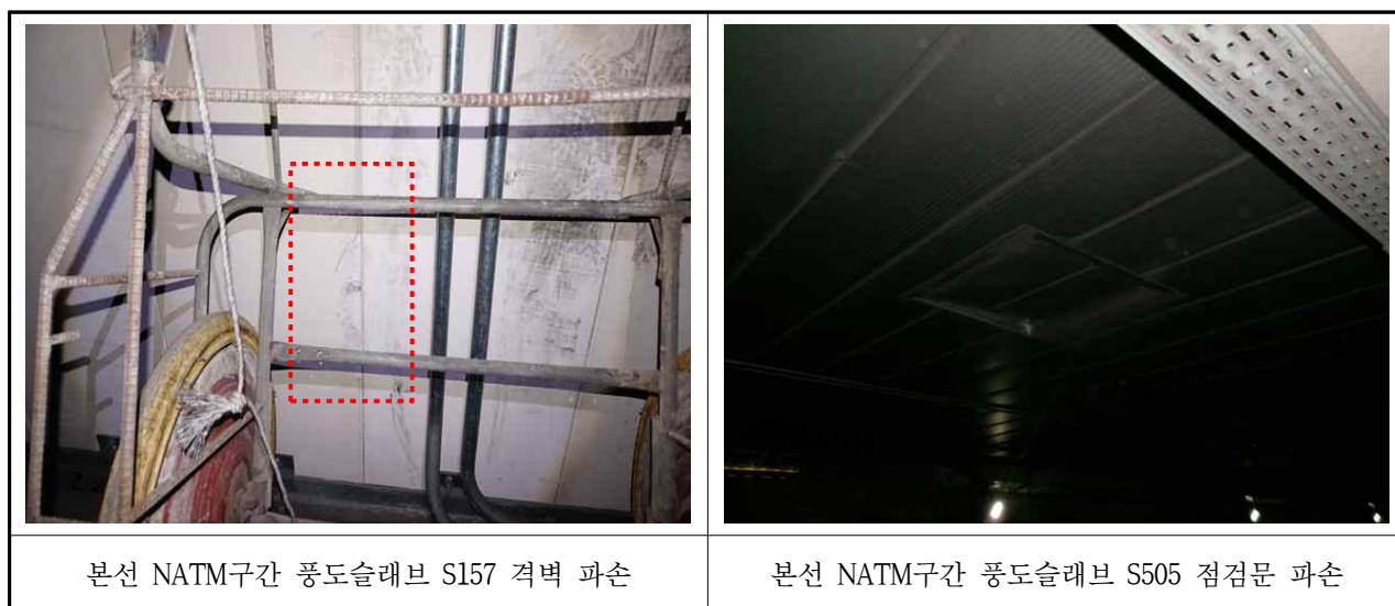
【사진 3.3.10】 NATM구간 풍도슬래브 손상현황
