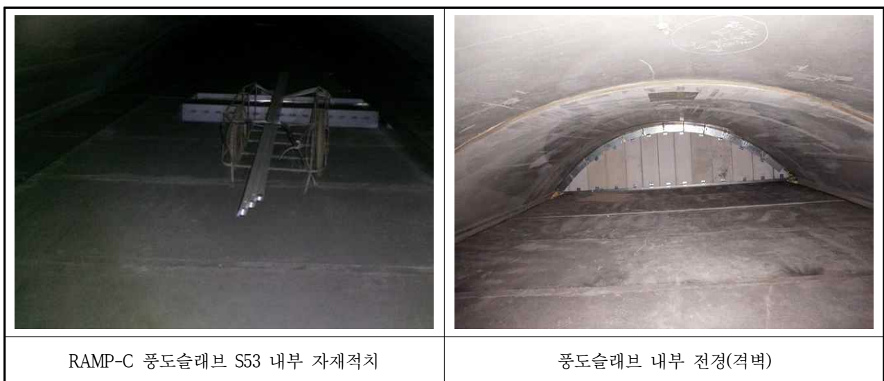
【사진 3.3.28】 NATM구간 풍도슬래브 손상현황
